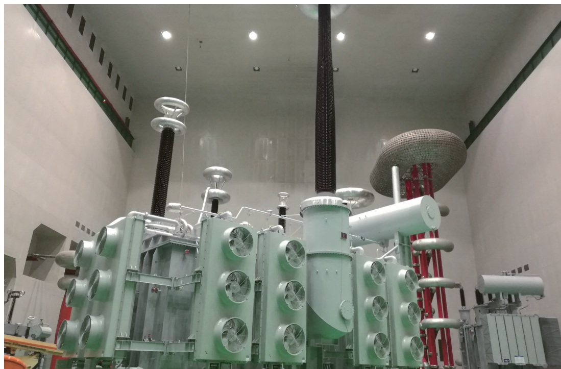
淮南 - 上海特高压工程苏州站 ODFPS-1000000/1000
