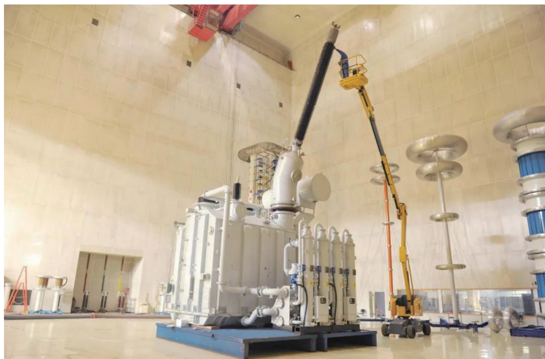
白鹤滩水电站 DSP-375000/500
