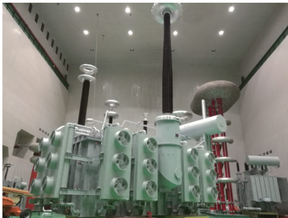
淮南 - 上海特高压工程苏州站 ODFPS-1000000/1000
